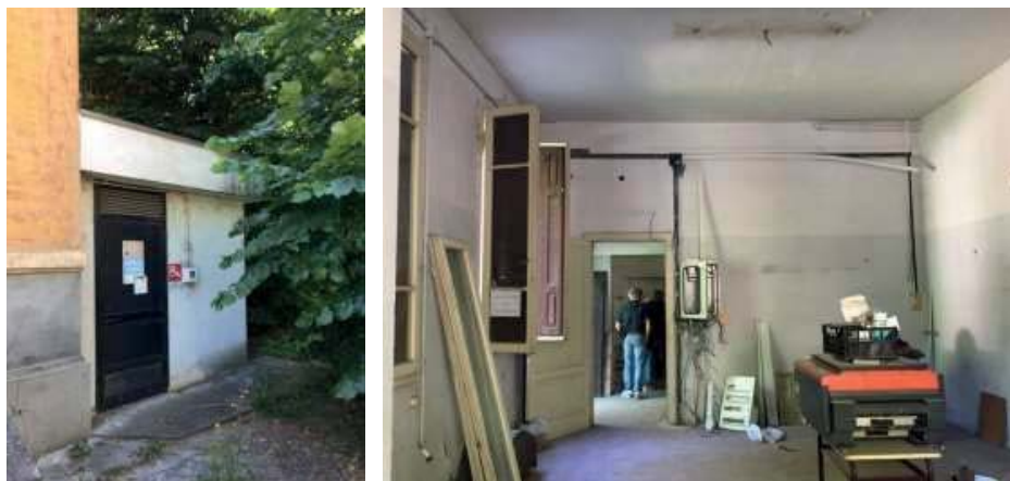
Centralina termica esterna e locali interni piano terra
