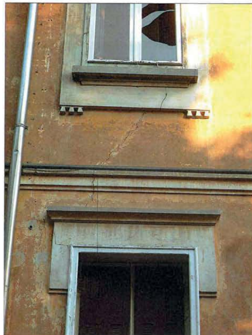
Esempio di Lesioni sui prospetti
